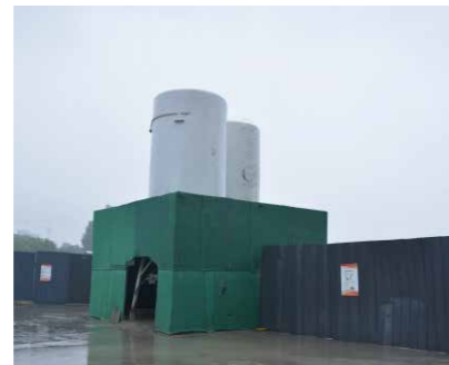
封闭式预拌砂浆罐
