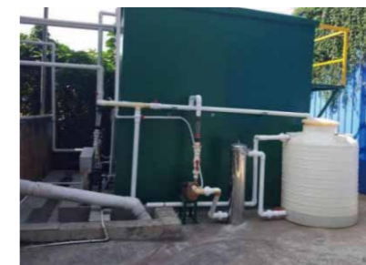
新增MBR膜生化池和废水检测设备
