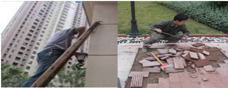
园区设施设备维修及养护
