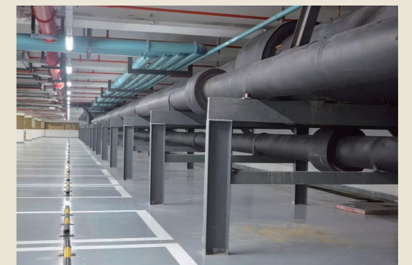
合肥万象城地下室管廊
